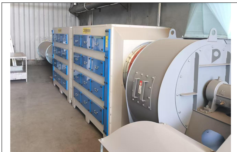
图 4-3 废气处理装置
